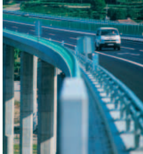
Nouvelle autoroute reliant Porto à Valença do Minho (à la frontière de la Galice), Portugal
